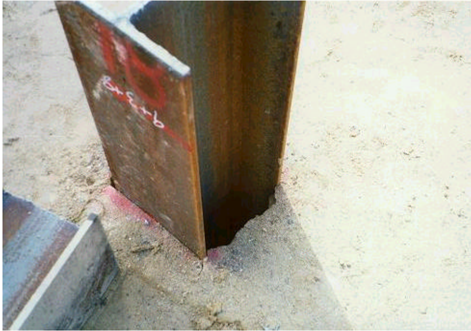
사진 A.27 말뚝 항타 후 말뚝주변에 발생한 함몰(모래 채움 전)
