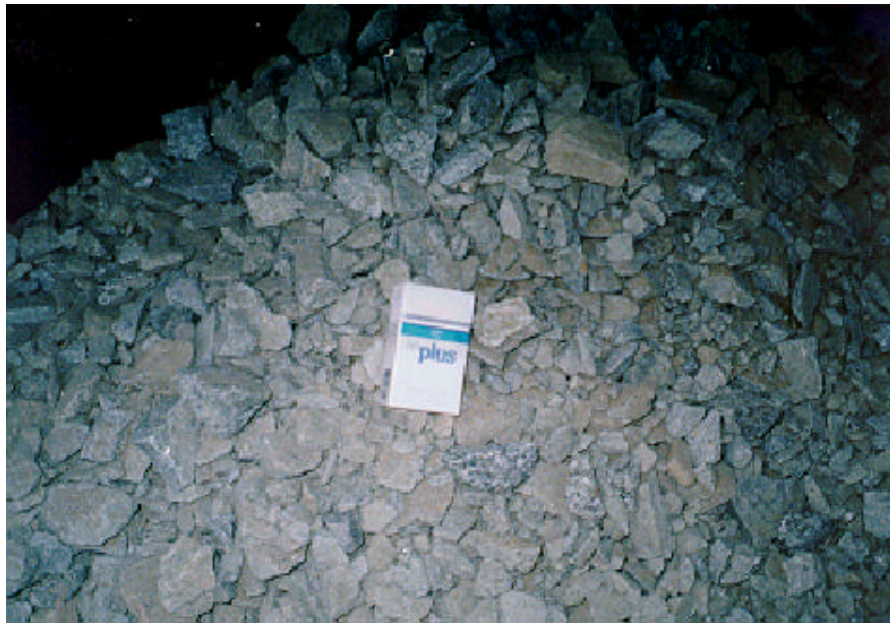
사진 A.76 교대 뒤채움재(배수재)로 사용된 골재의 모습
